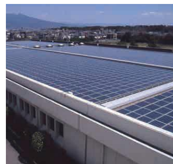
西部浄化センター太陽光パネル
